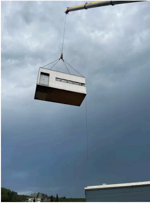
Die Sushibox schwebt über das Dach der ehemaligen Credit Suisse. Bilder: zvg/Patrick Nöthiger
